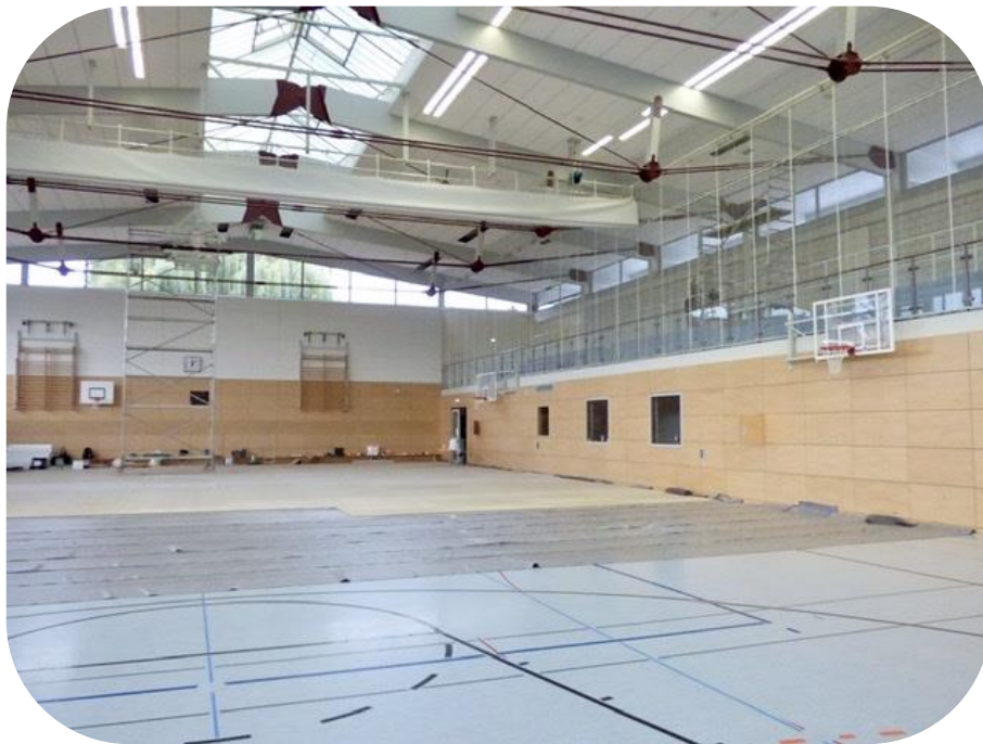
Abb. 20: LED-Beleuchtung der Sporthalle Heringen (eigene Fotografie)
